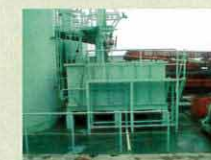
甲板上の二次・三次タンク
