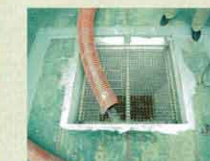
甲板下一次タンクへの集水
